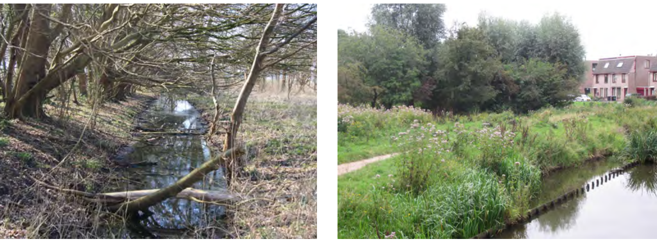
Watergangen met omgevallen houtopstanden en afkalvende oevers
